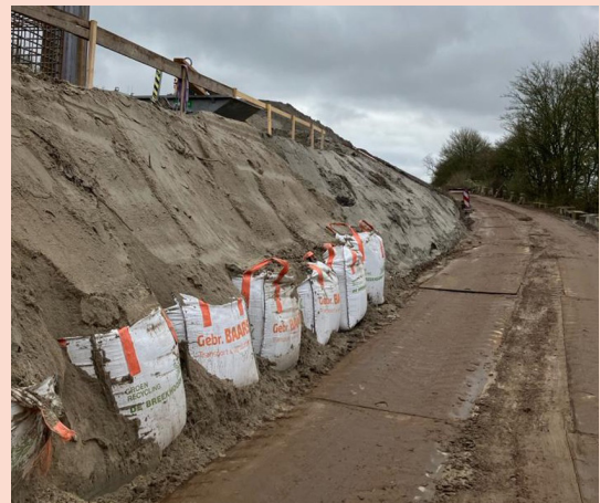
De voorbelasting aangebracht naast onze bouwweg tussen de Nieuwemeerdijk en de Zuidtangent
